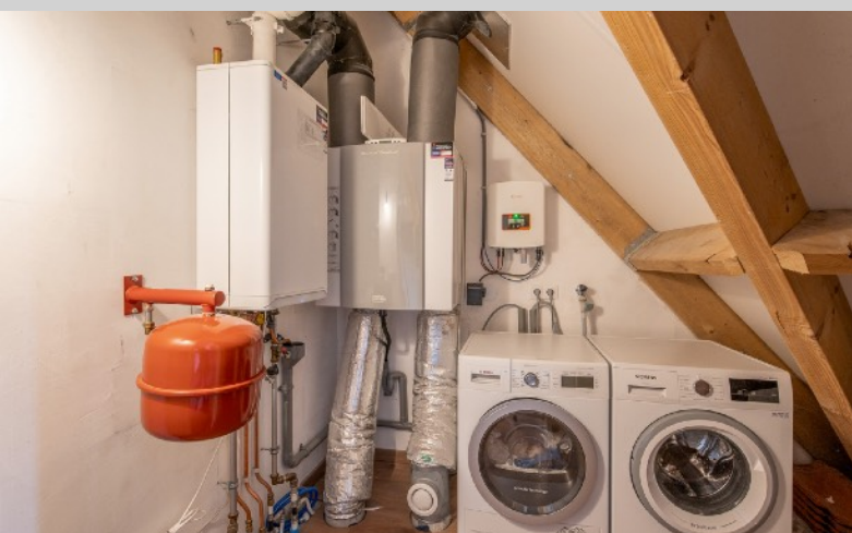
Waskamer/technische ruimte met opstelling van cv-ketel (Intergas Xtreme 36 HR, 2018), omvormer van de 2 zonnepanelen, unit van de balansventilatie en aansluitpunt voor de wasapparatuur.
