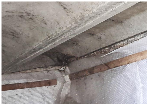
Foto 1. Mechanische schade t.p.v. de oplegging
