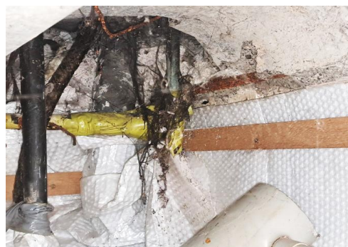
Foto 2. Mechanische schade t.p.v. doorvoerleiding
