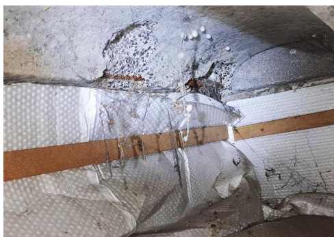
Foto 1. Mechanische schade t.p.v. de oplegging
