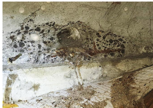
Foto 2. Mechanische schade t.p.v. ventilatiegat
