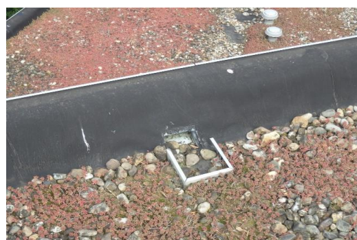
36: aanwezige hemelwaterafvoer (stadsuitloop)
