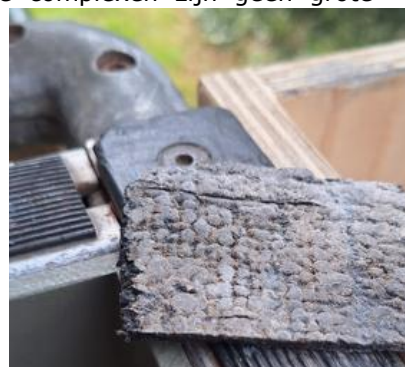
Figuur 4: Aangetroffen bitumenafdekking in spouwmuur westzijde langsgevels (Laneco, 2026).
