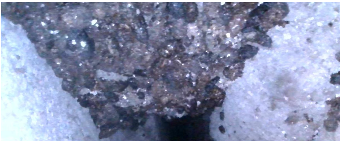
Figuur 7: Uitwerpselen van vleermuizen in spouwmuur binnengevel Diedenweg 111 (Laneco, 2026).
