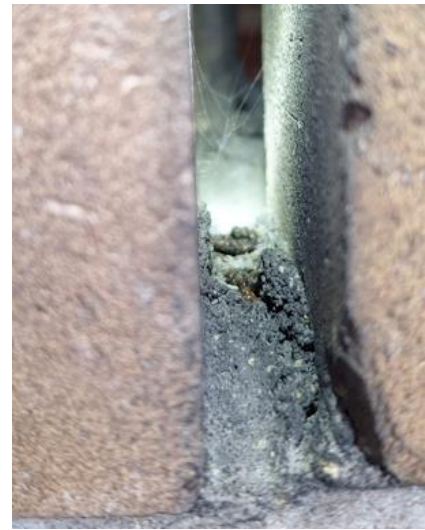
Figuur 2: Uitwerpselen vleermuizen in ventilatievoegen Diedenweg 99 Wageningen. (Laneco, 2026).
