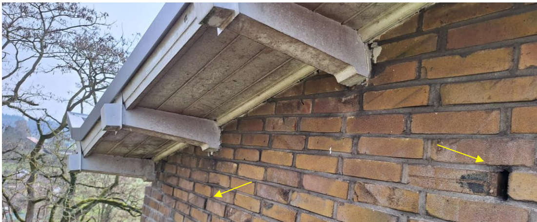
Figuur 6: Open stootvoegen op kopgevel Diedenweg 109 (Laneco, 2026).
