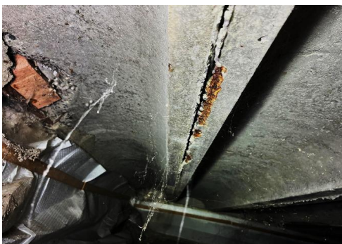
Foto 5. Schade door geringe dekking
