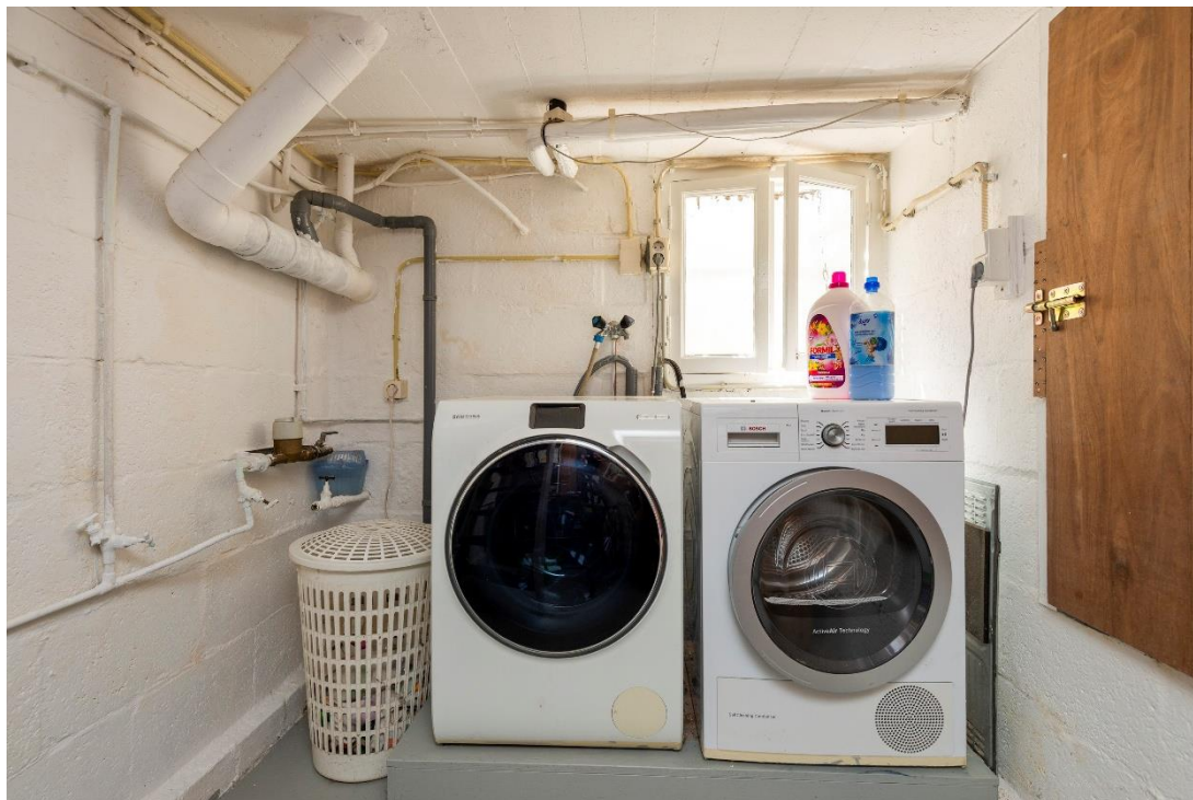
Kelder met wasmachine-/drogeropstelling
