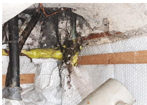
Foto 2. Mechanische schade t.p.v. doorvoering
