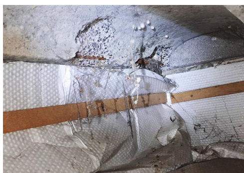
Foto 1. Mechanische schade t.p.v. de oplegging
