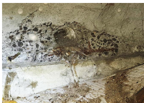
Foto 2. Mechanische schade t.p.v. ventilatiegat
