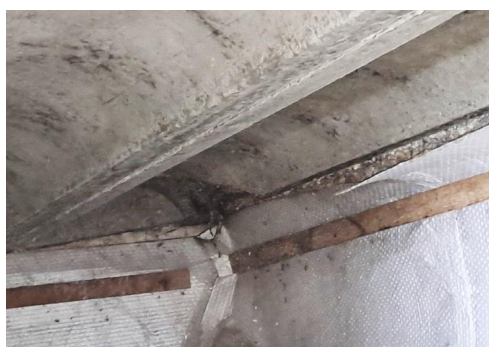
Foto 1. Mechanische schade t.p.v. de oplegging
