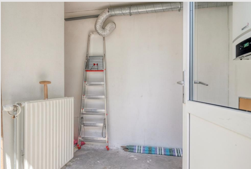
Abstellraum mit Zentralheizungsanlage.
