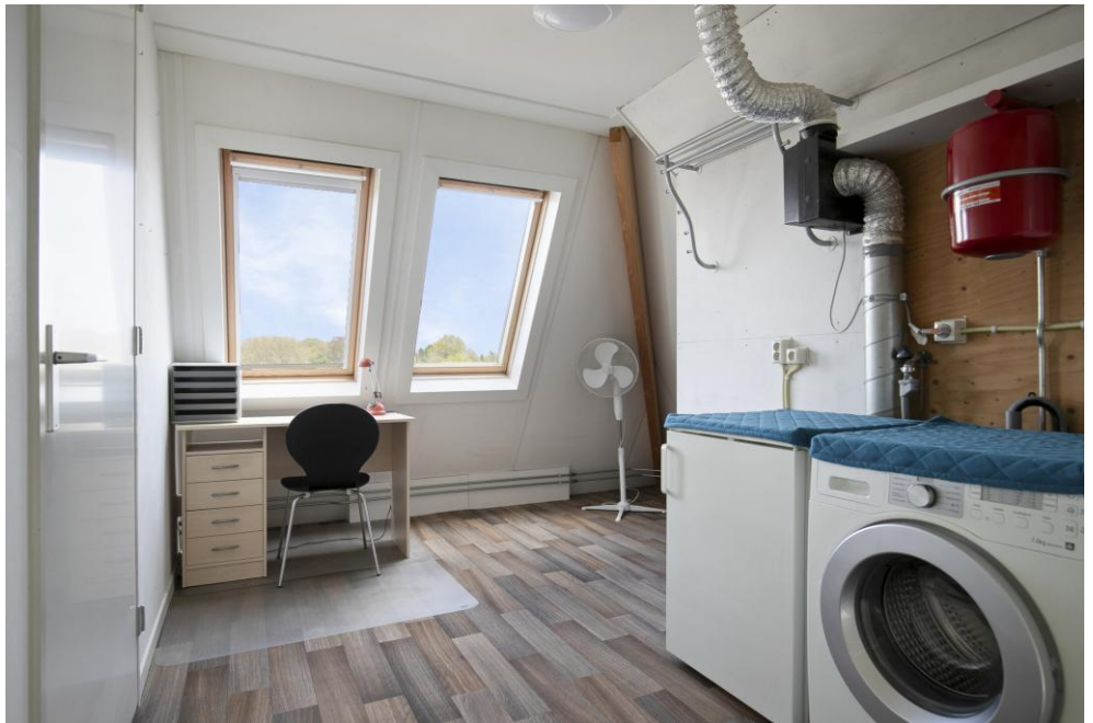
Technische ruimte en opstelling wasapparatuur
