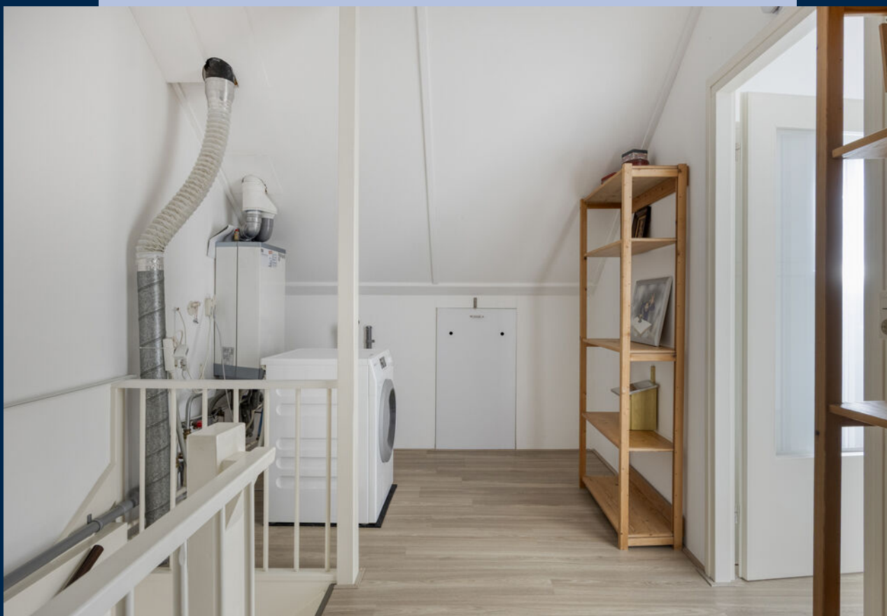
De tweede verdieping heeft een ruime overloop met opstelling van de cv-ketel en aansluitingen voor wasmachine en droger.
