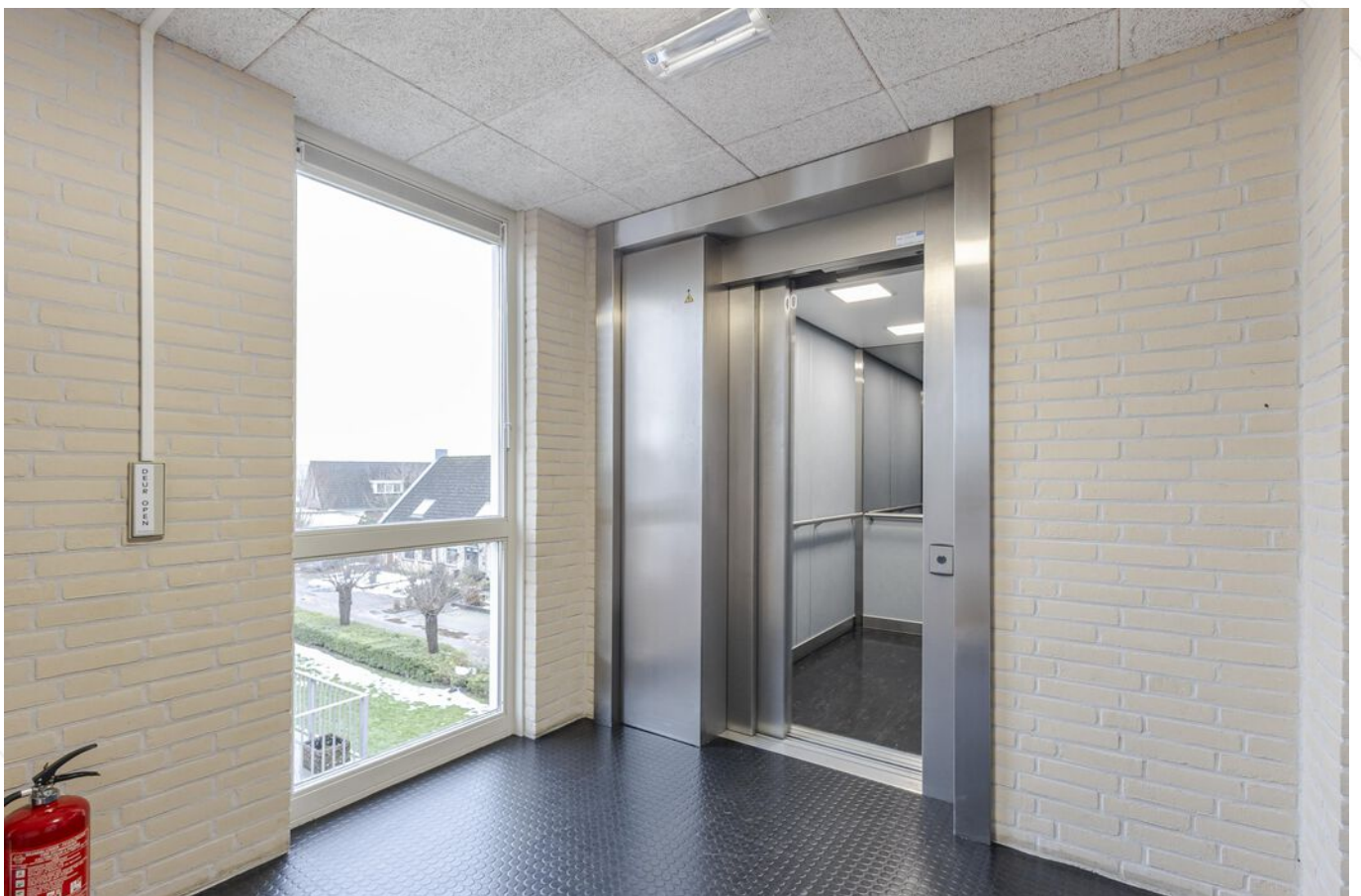
Centrale hal met liftinstallatie
