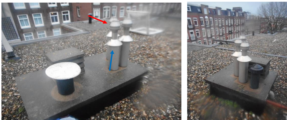
Foto links; strang 2 met drie individuele rookgasafvoeruitmondungen (rode pijl). De verbrandingslucht wordt via de opening bij de afscherming betrokken (blauwe pijl). Op de foto rechts strang 3 met een gelijksoortige uitvoering.
