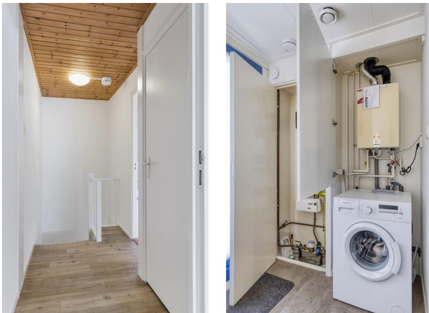
De overloop op de 1 ste verdieping en in de keuken de meterkast en c.v. opstelling.
