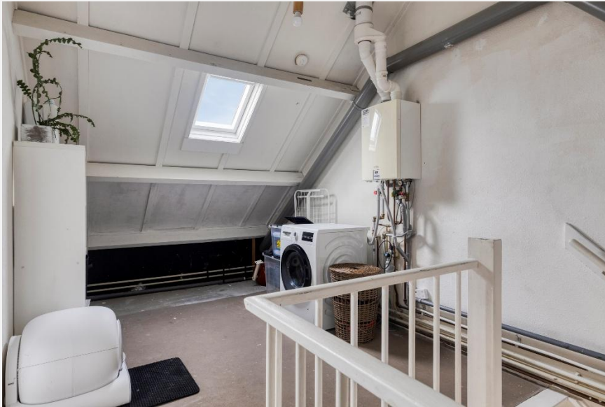
Op de 2 de verdieping bevindt zich de c.v.-opstelling en de wasmachine aansluiting.
