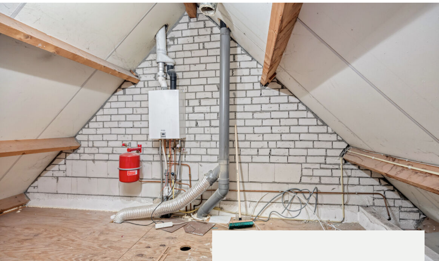
Grote bergzolder met opstelling c.v.- combiketel.
