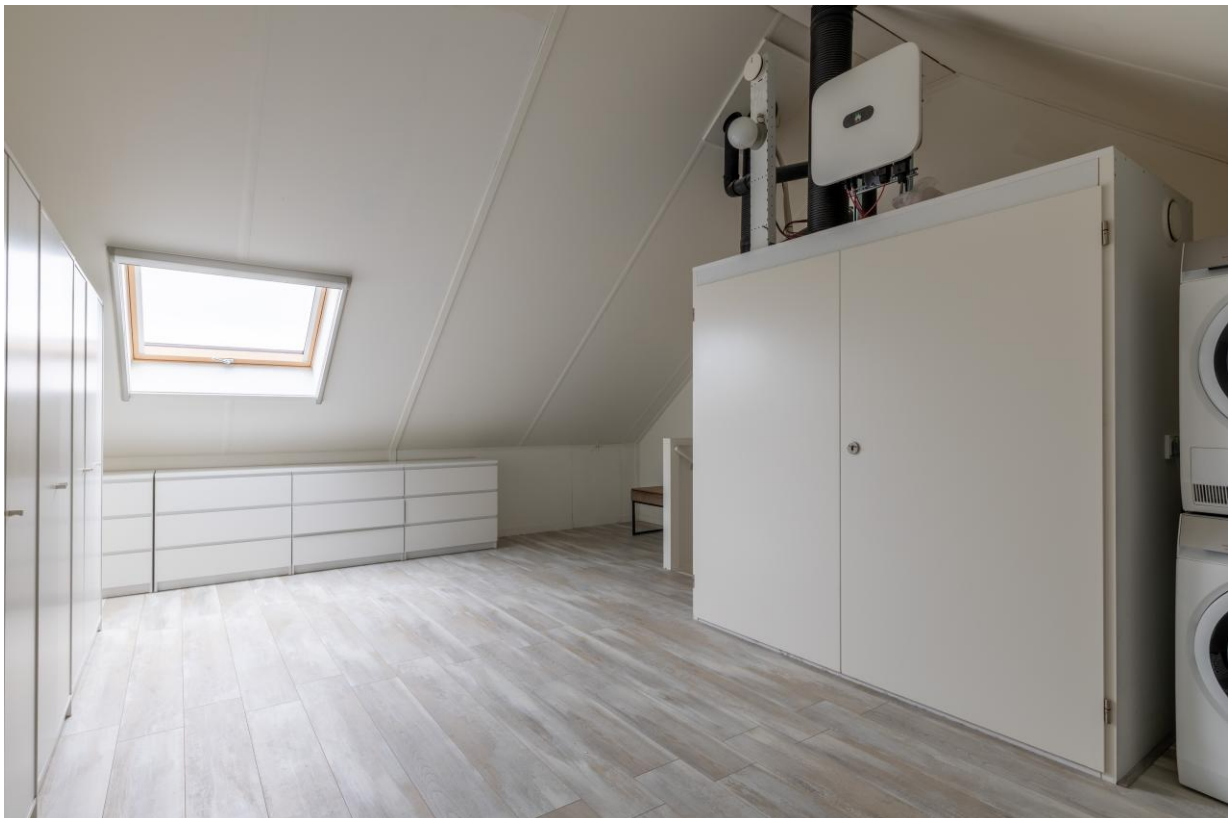
Impressie van de afgesloten techniekruimte alwaar zich o.a. de warmtepomp, balansventilatie en omvormer bevinden
