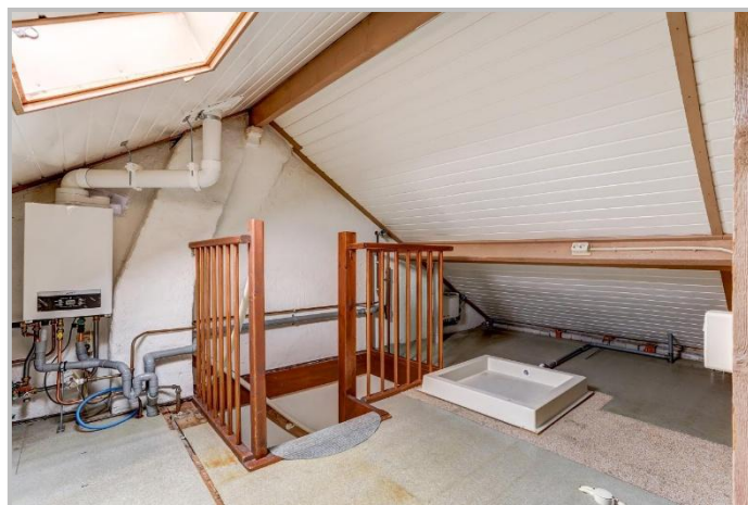
2 e verdieping met dakraam, c.v. ketel en wasmachine-aansluiting
