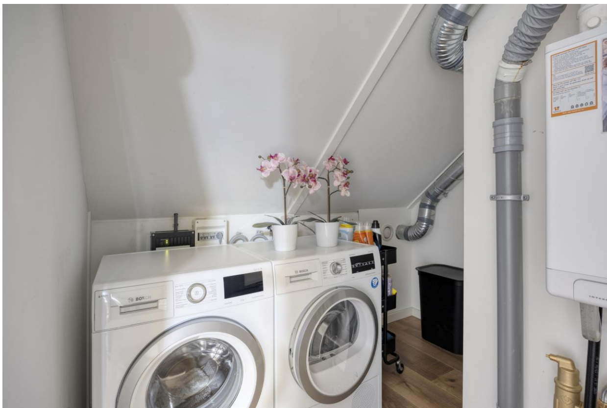
Technische ruimte met opstelling cv-combiketel (merk Intergas, bouwjaar: 2025), aansluitingen wasapparatuur, mechanische ventilatie-unit (2024) en omvormer voor de zonnepanelen (2023).
