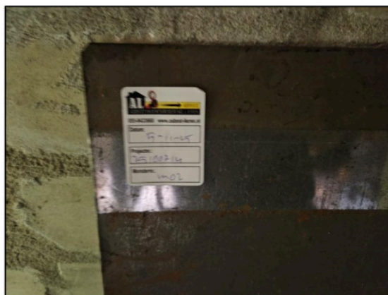
Foto 4: Bron 2: Zolder: Hitteschild (Niet asbesthoudend)
