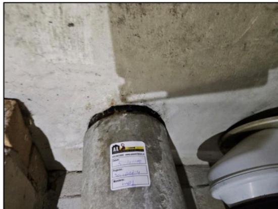
Foto 2: Bron 1: Zolder: Ventilatiebuis (Asbesthoudend)
