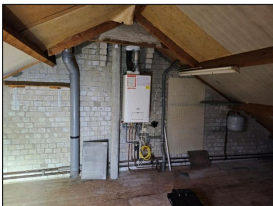
Foto 3: Bron 1: Zolder: Ventilatiebuis (Asbesthoudend)
