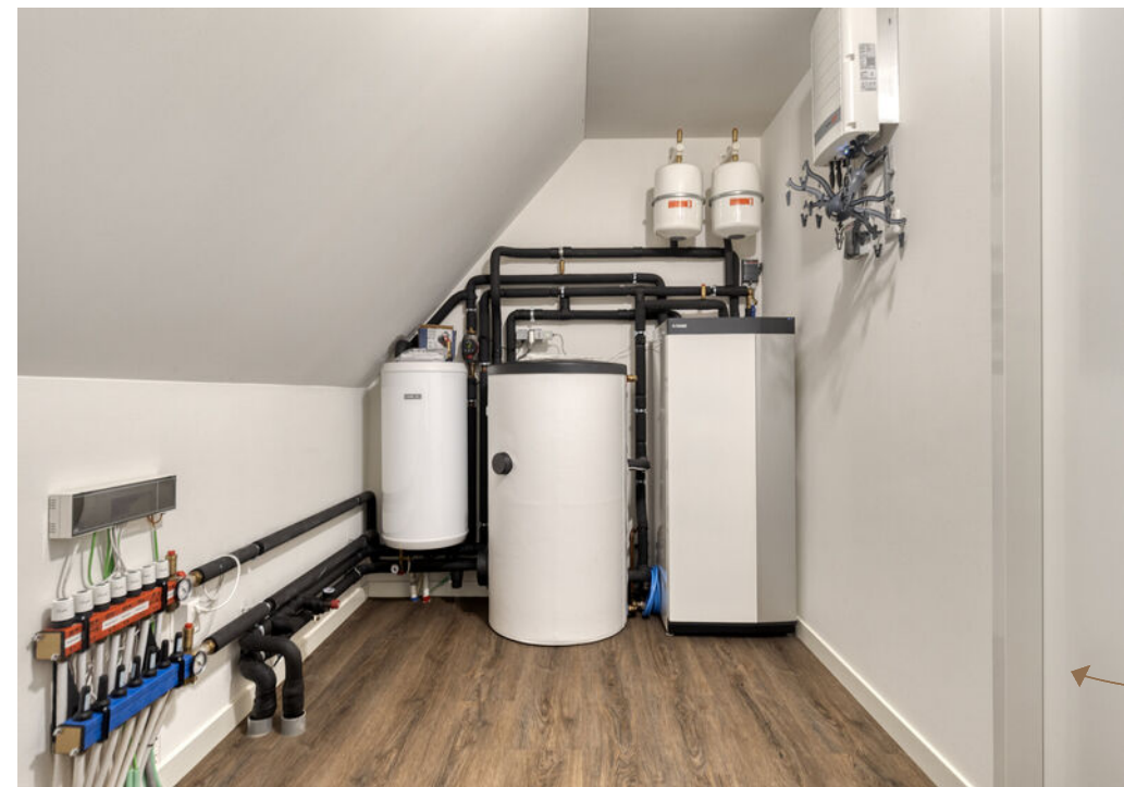
Praktische bergruimte met technische installaties
