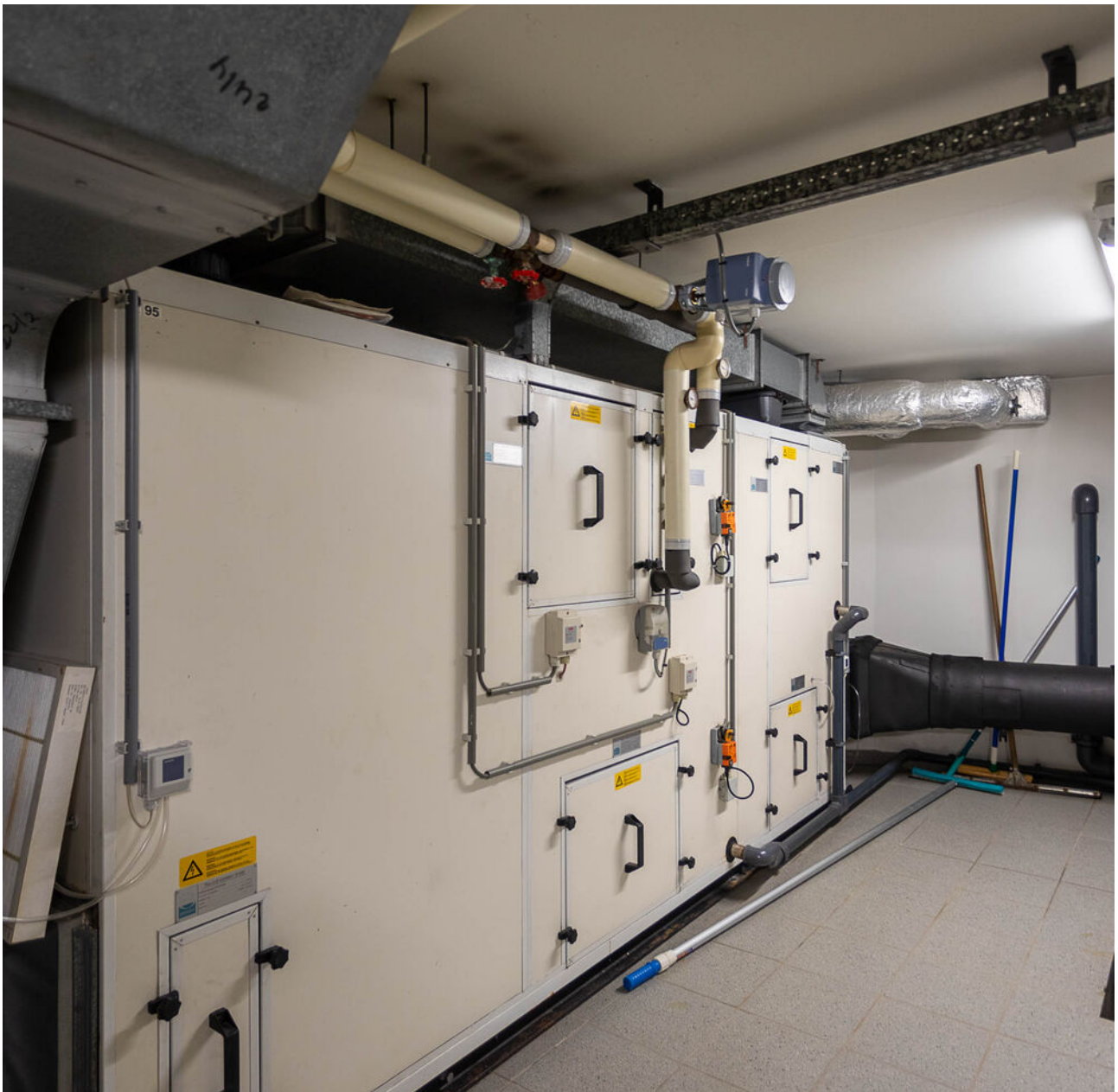
Zwembad installatie in kelder
